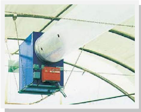
Chauffage par gaine polyane permettant une parfaite répartition de l'air chaud en serre
